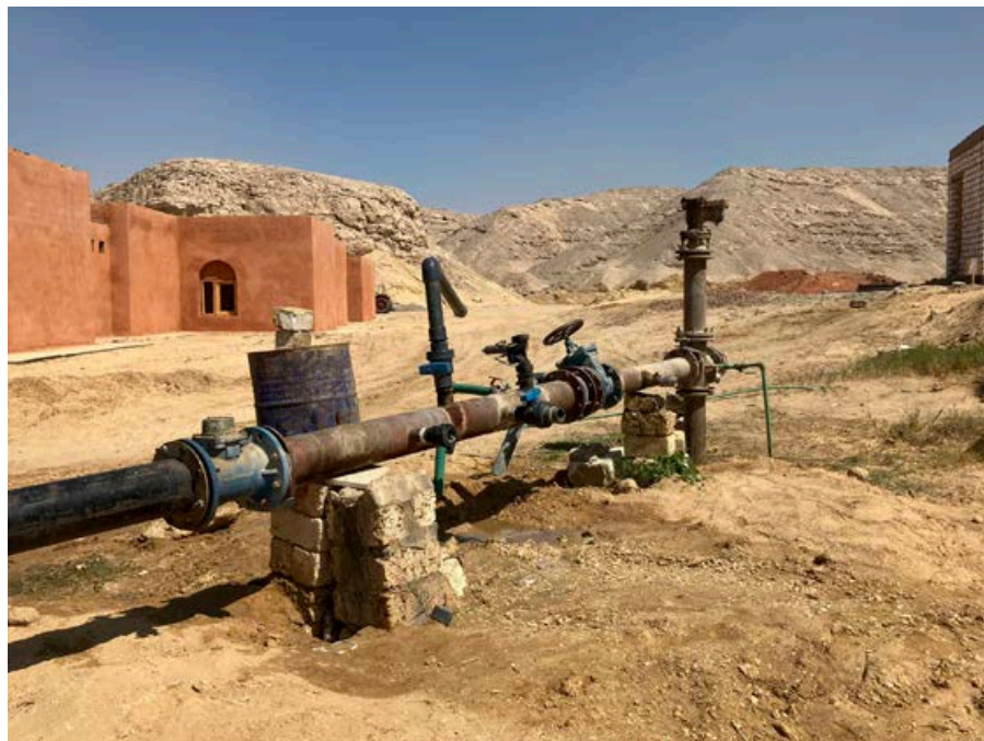
Pumpanlage eines Biobetriebs in Ägypten, der Zugang auf eine erneuerbare Wasserressource hat.
